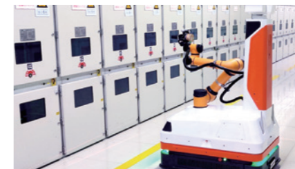
高压配电柜操作
