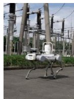
国内首次实现机器狗全自主巡检变电站
