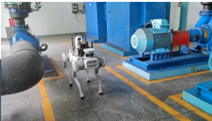
国网雄安新区 某集控站智能巡检
