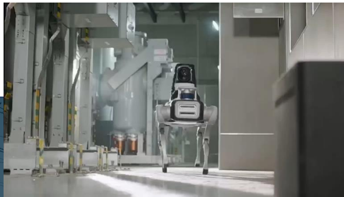
海南 某热电厂智能巡检
